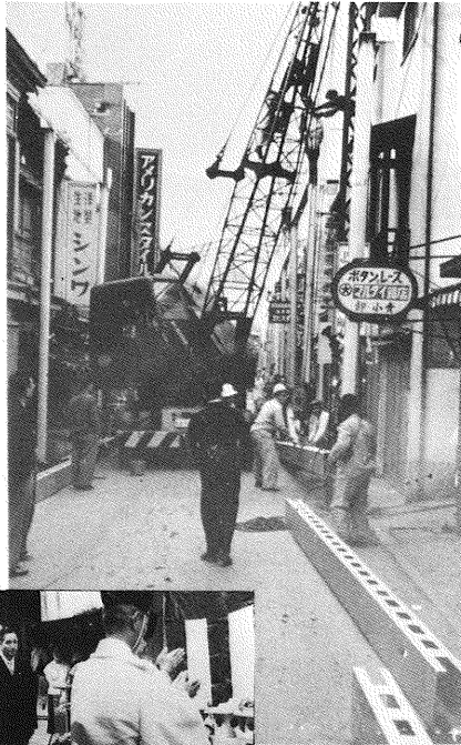
アーケードの組立て作業と下は 三宮神社清水宮司による地鎮祭
