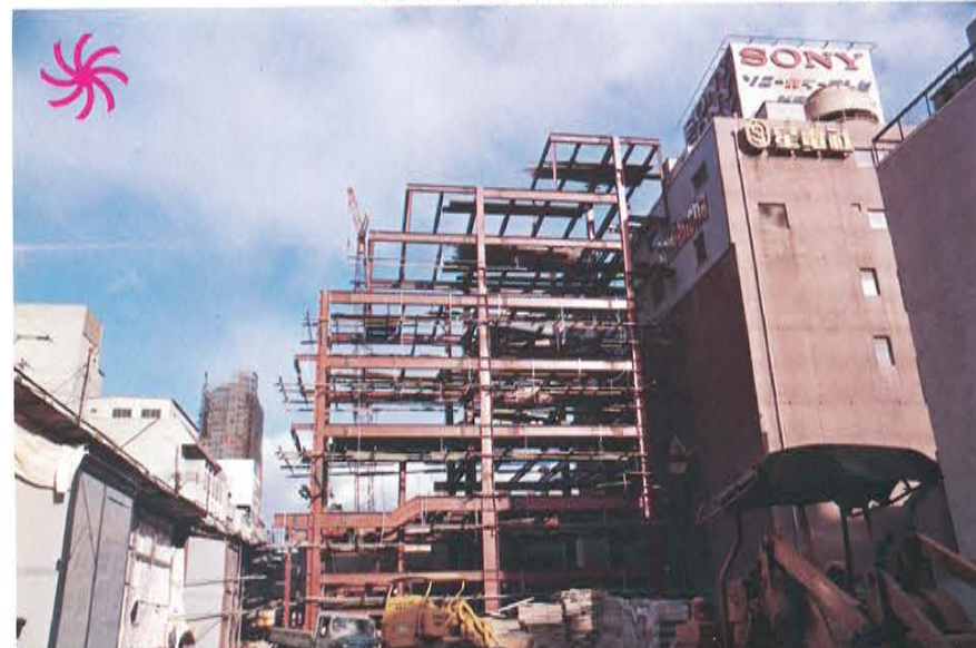
▼さんセンター工事中。センター街再開発事業の第一号、第一防災の工事現場(S. 43. 12) ▶珍しく雪におおわれたさんプラザ工事現場(S. 44. 2)
